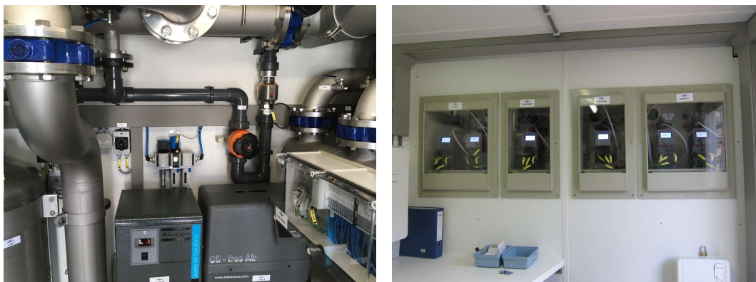
Compresseur d'air et pompes doseuses produits chimiques
